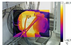
Aislación Motor eléctrico
